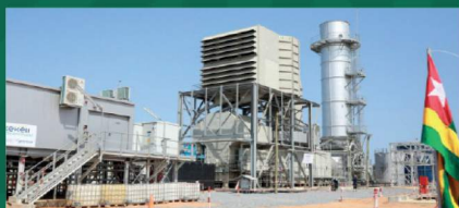
CENTRALE THERMIQUE KEKELI EFFICIENT POWER
