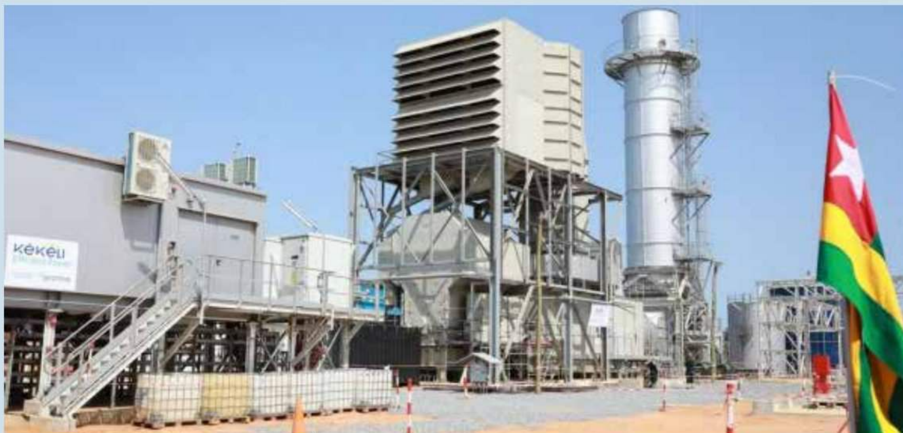
Centrale thermique KEKELI Efficient Power
